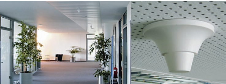
Deckenmontage mit Rundstrahlantenne
